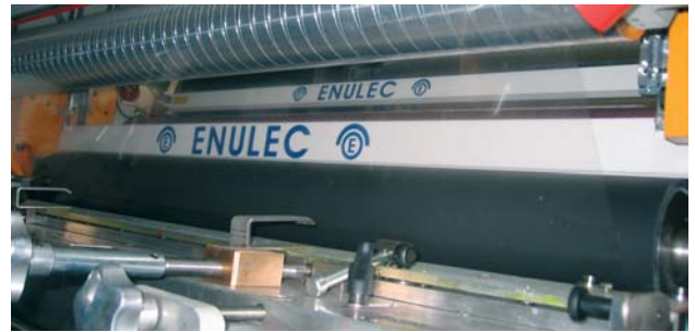
Eine Enulec-ESA-Anlage installiert in einem Tiefdruckwerk.
